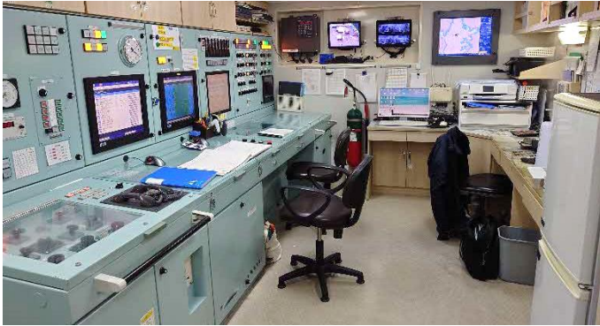
機関制御室です。電気に清水、生活に必要なエネルギーはここで管理されています。神海丸の心臓です。
