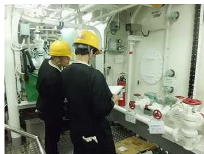
機関科生徒の停泊中の船内学習。機関室内設備の調査と確認作業
